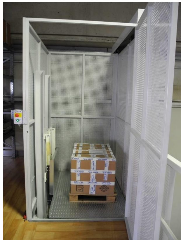
Protezioni al piano superiore con cancelletto ad un'anta ed elettroserratura di sicurezza
